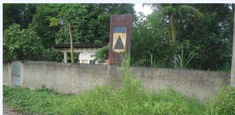
Escritório de Obras do Dnit em Teixeira de Freitas funciona num prédio em péssimo estado de conservação
